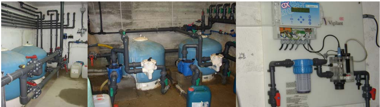
Detalle depuradoras piscinas públicas y equipo de regulación y control de cloro y pH.
